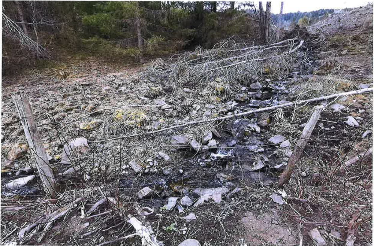
Figur 5: Bekk 1 i toppen av hensynssonen. Bekken er svært erosjonsutsatt
