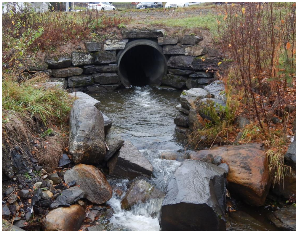
Bilde 4-18 Utløp DN1600 gjennom Fv. 255
