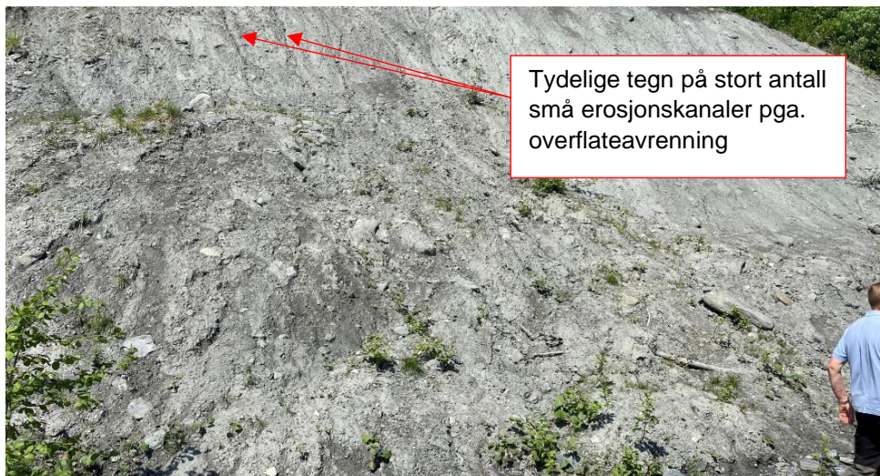
Figur 3-4. Tegn på erosjon pga. overflateavrenning.
