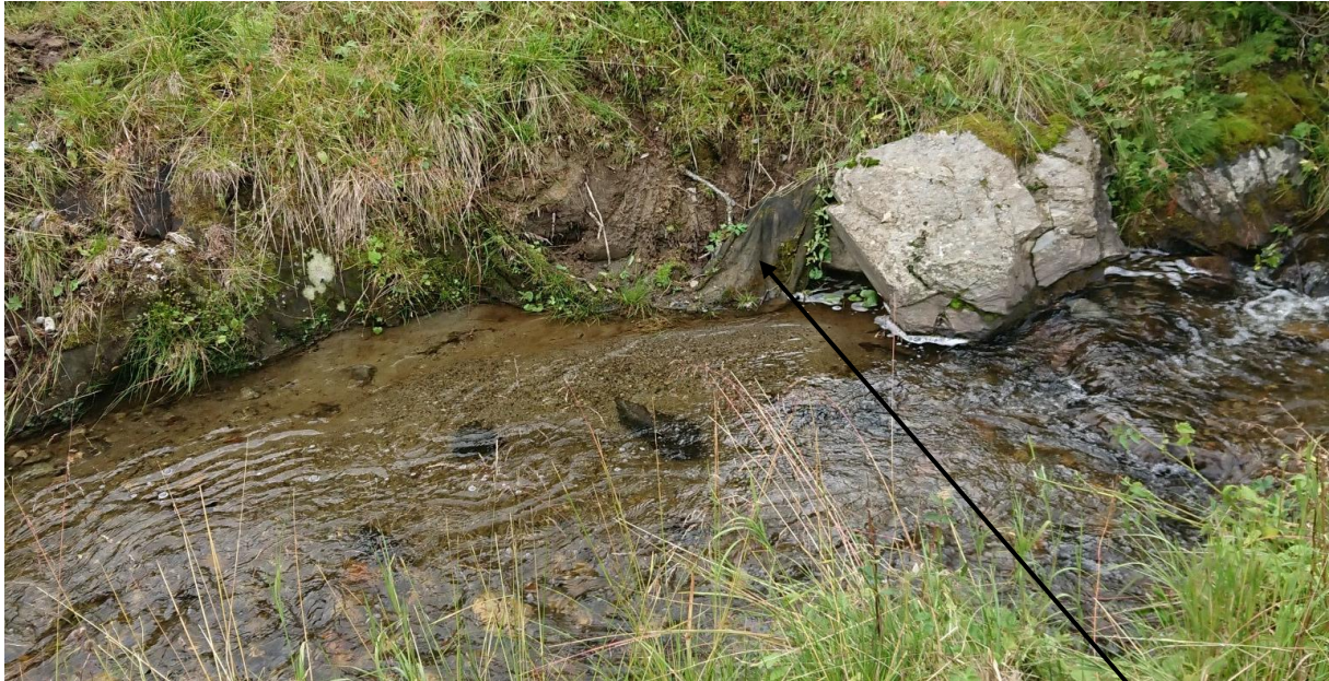
Bilde 24. Ødelagt plastring av bekkekant utenfor Segalstadsetervegen 47.
