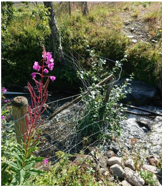
Bilde 30. Ødelagt gjerde ved Segalstadsetervegen 53 (223/44).
