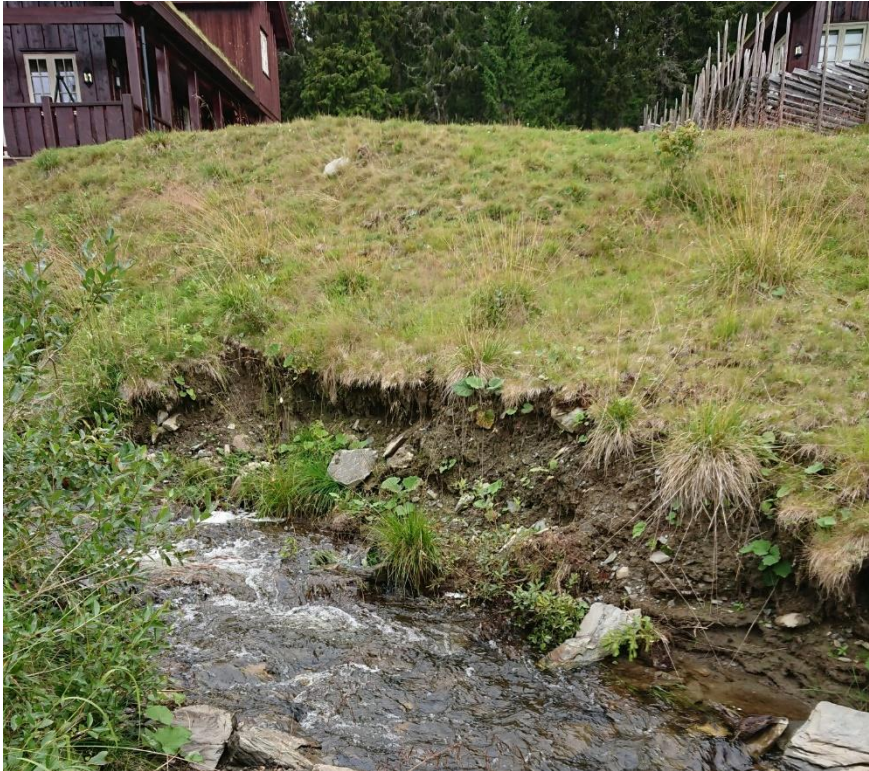
Bilde 17. Erosjon i svingen foran Majorsligutua 10.
