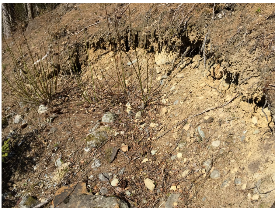
Figur 8. Nylig utglidning ovenfor en enebolig ved Ringen i den sørligste delen av undersøkelsesområdet. Materialet inneholder en betydelig andel finstoff (sand, silt og leire).
