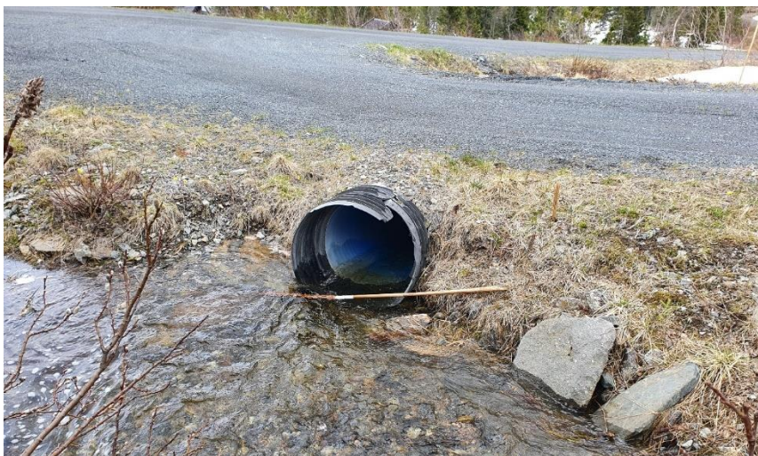
Figur 11: Innløpet til stikkrenne 3. Flomveien går over den nærmeste veggen mot stikkrenne 4, som ligger i innersvingen til veggen på bildet.
