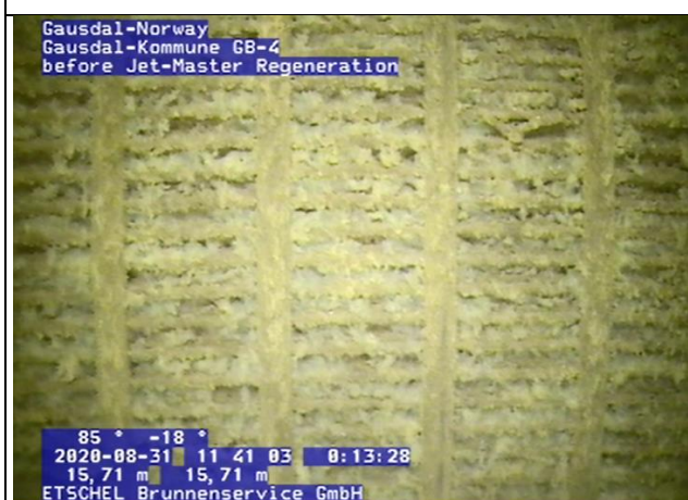
Figur 7. GB4 ved 15,7 m dybde, før rehabilitering.
