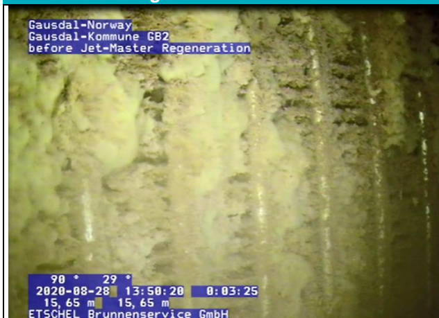
Figur 3. GB2 ved 15,6 m dybde, før rehabilitering.
