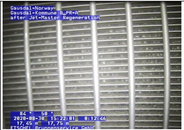
Figur 10. B_Pr-A ved 17,75 m dybde, etter rehabilitering.
