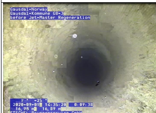
Figur 5. GB3 ved 17 m dybde, før rehabilitering.
