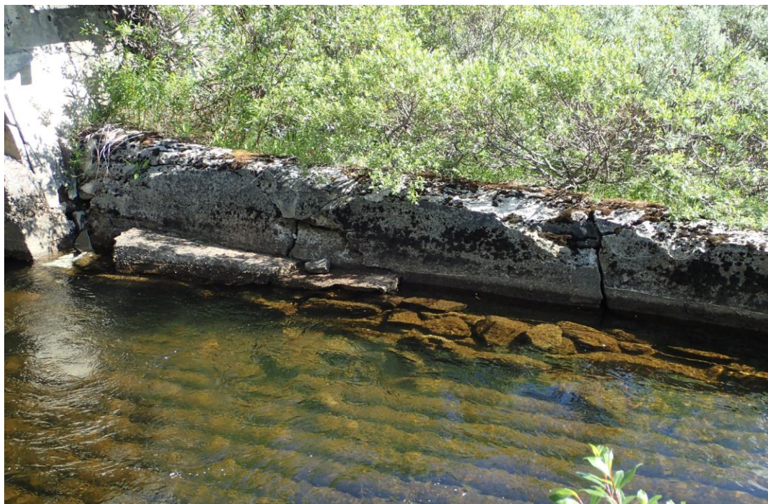
Figur 2-9 Undergaving og oppsprekking av sidemurer rett nedstrøms dammen.
