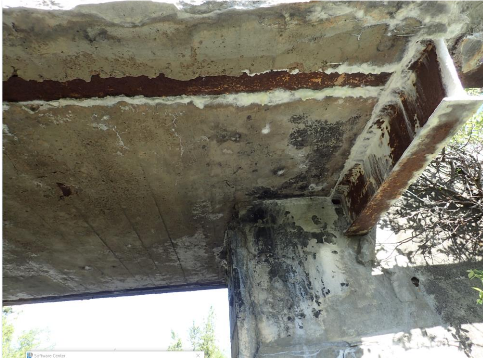
Figur 2-7 Kalkutslag og avskalling under broen over nåleløpet
