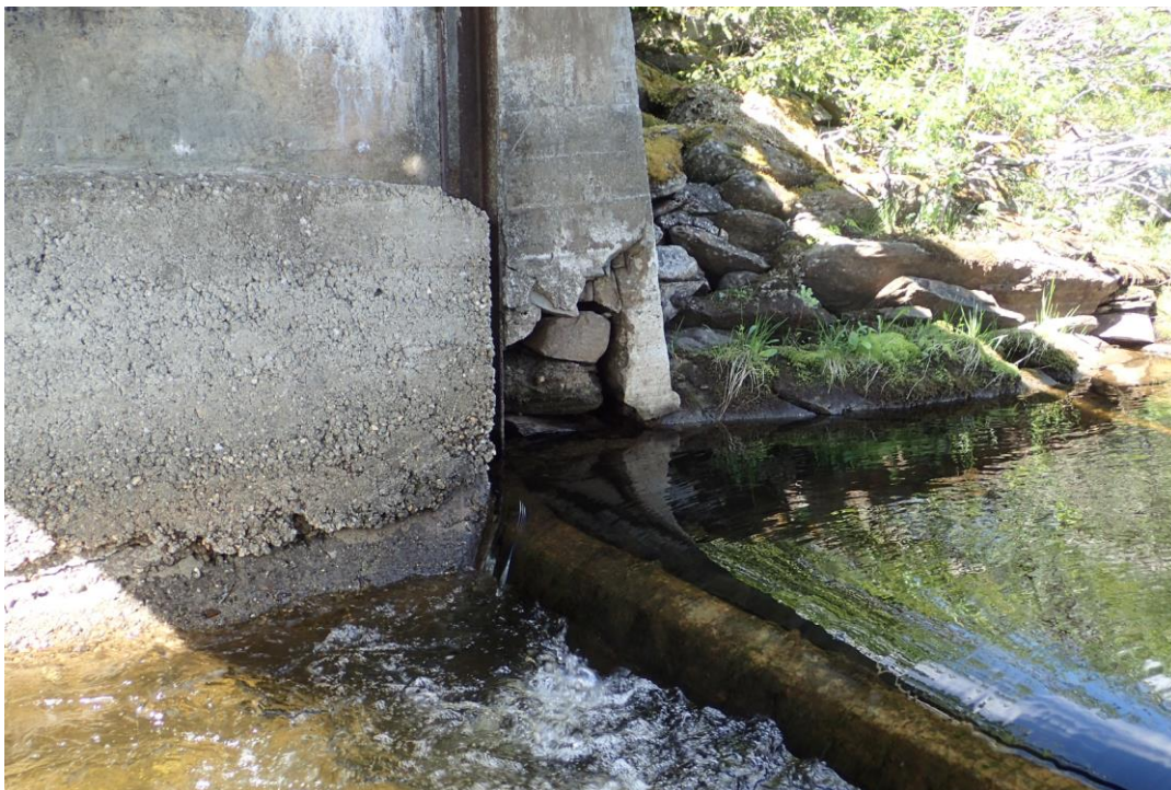
Figur 2-8 Utvasking undergraving i nåleløpet. Påstøp fra 1987 til venstre i bildet.
